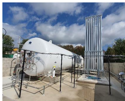
Imagen 57: Depósito de GNL de Miraflores de la Sierra
