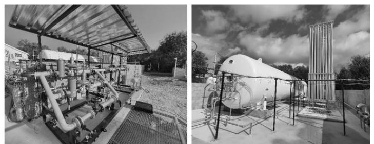
Imagen 17 Planta de GNL nueva instalada en Miraflores de la Sierra
