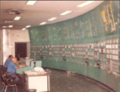
Detalle del centro de control de las plantas Snams y Lurgi, en Manoteras, para fabricación de gas manufacturado.
